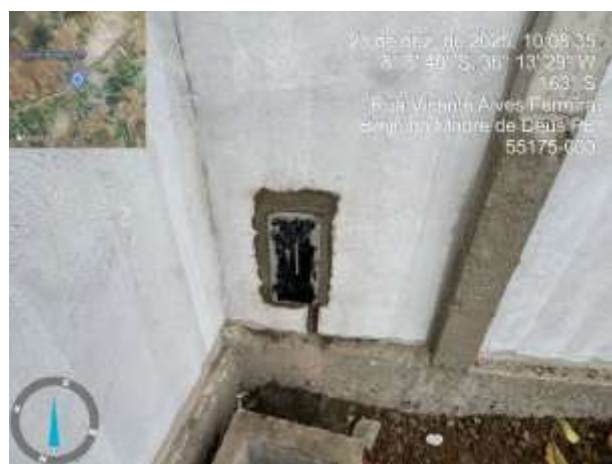
FOTO 06: ENTRADA DE ENERGIA;
