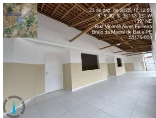
FOTO 05: PINTURA COM TINTA LÁTEX ACRÍLICA;
