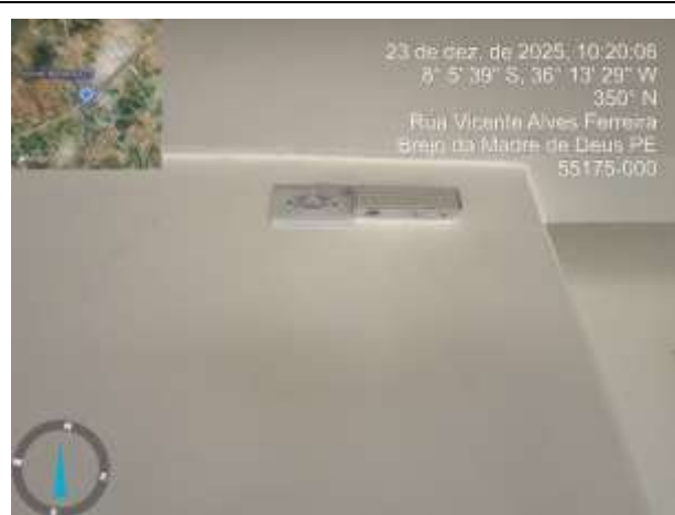
FOTO 01: LUMINÁRIA DE EMERGÊNCIA;
